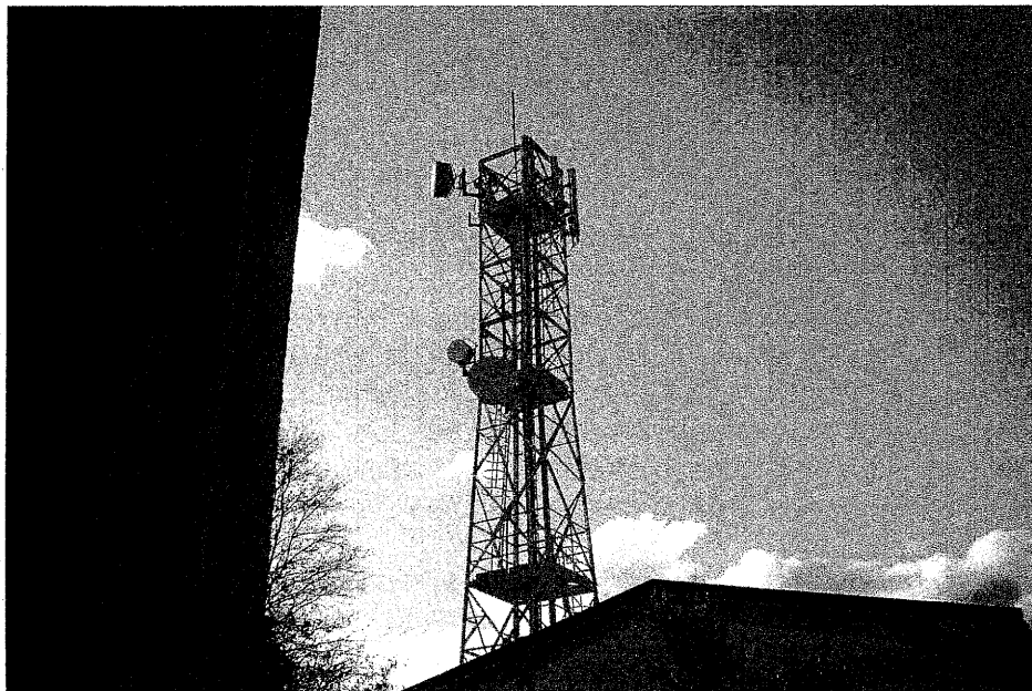
Foto dei ponti radio e della stazione radio base in via della Rocca – Castiglione d'Orcia
