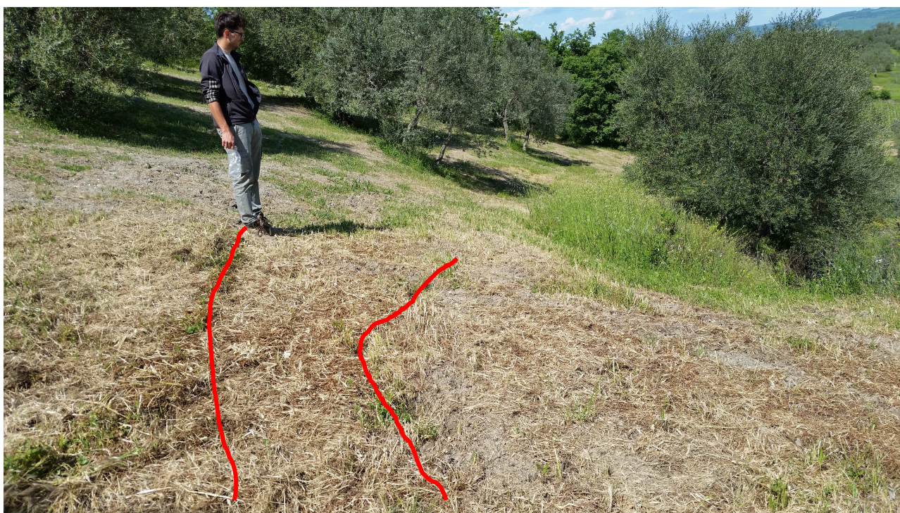
Foto 2 – Particolare della presenza di fratture di trazione (indicate in rosso) poste a monte della scarpata principale testimoniando lo stato di attività del movimento
