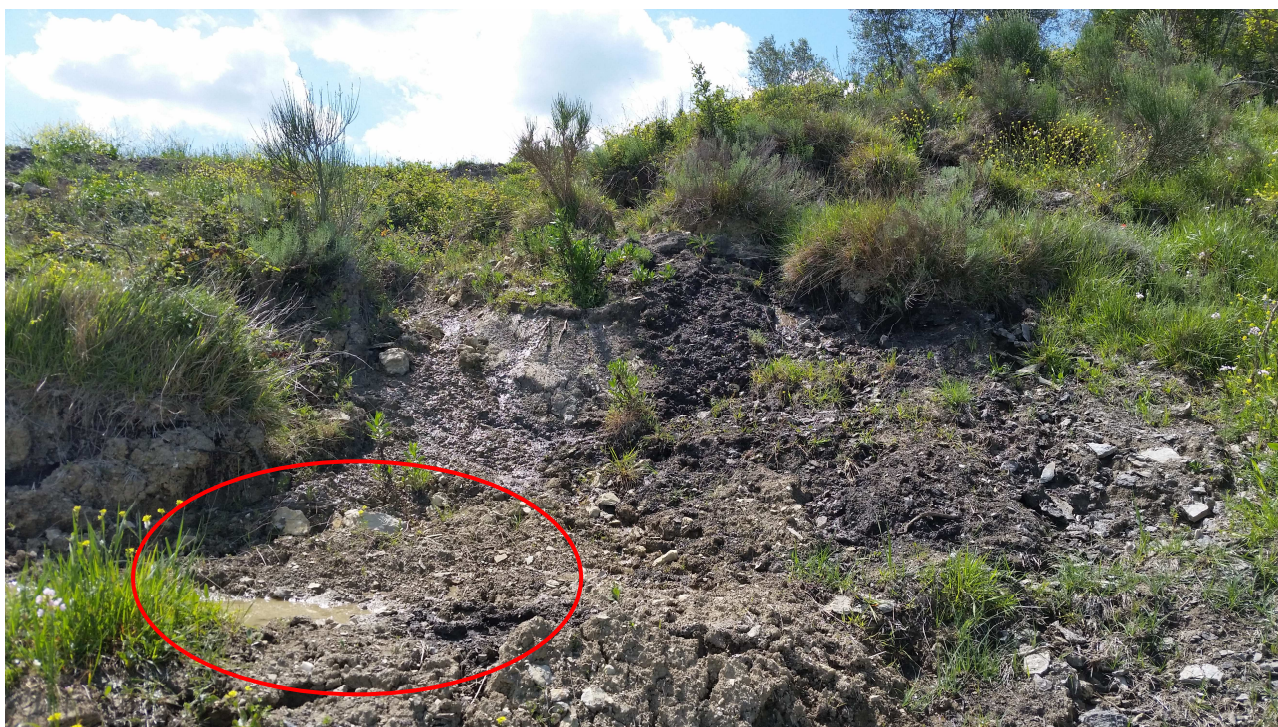
Foto 1 – Particolare della scarpata principale con evidenze di venute di acqua da monte
